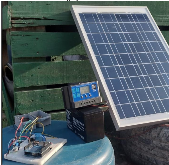
Figura 4: Sistema de Irrigação Solar Automatizado completo
